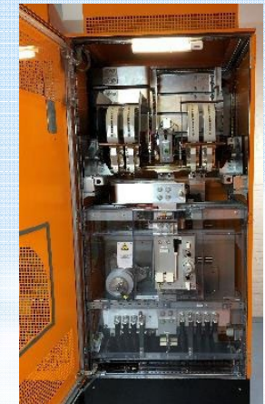
DC Schalter und Schutzelemente
