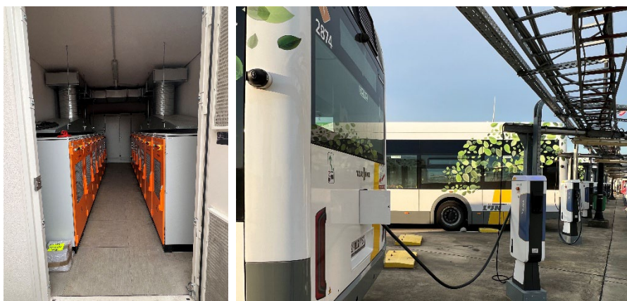
Abbildung 2-5 Beispiel für die Unterbringung von Leistungseinheiten in einer separaten Einhausung und Beispiel für einen Anfahrerschutz
