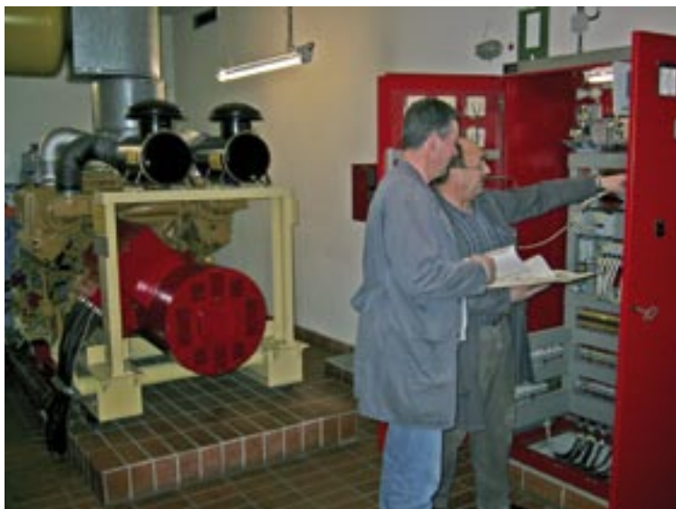
Inspektion einer Dieselgeneratoreinheit einer unterirdischen Haltestelle der Stadtbahn Frankfurt am Main
